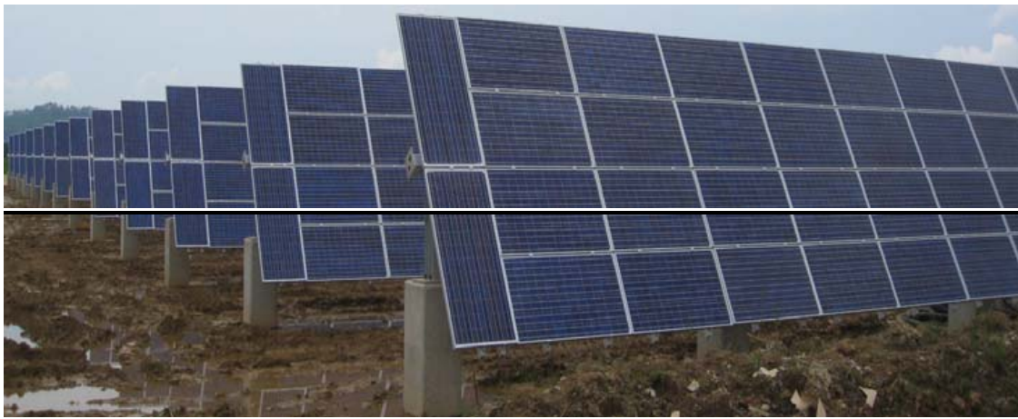
Jindo 3MW Project
